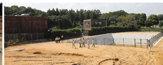
▲開発行為により設置しなければならない調整池(豪雨等による下流河川氾濫を防止するため)一時的に水を貯めておく施設
