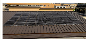
太陽光パネル(保健センター屋根)
