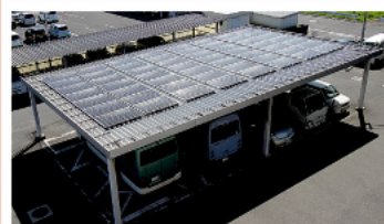
太陽光パネル(庁舎駐車場屋根)
