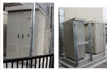
蓄電設備 (庁舎)
