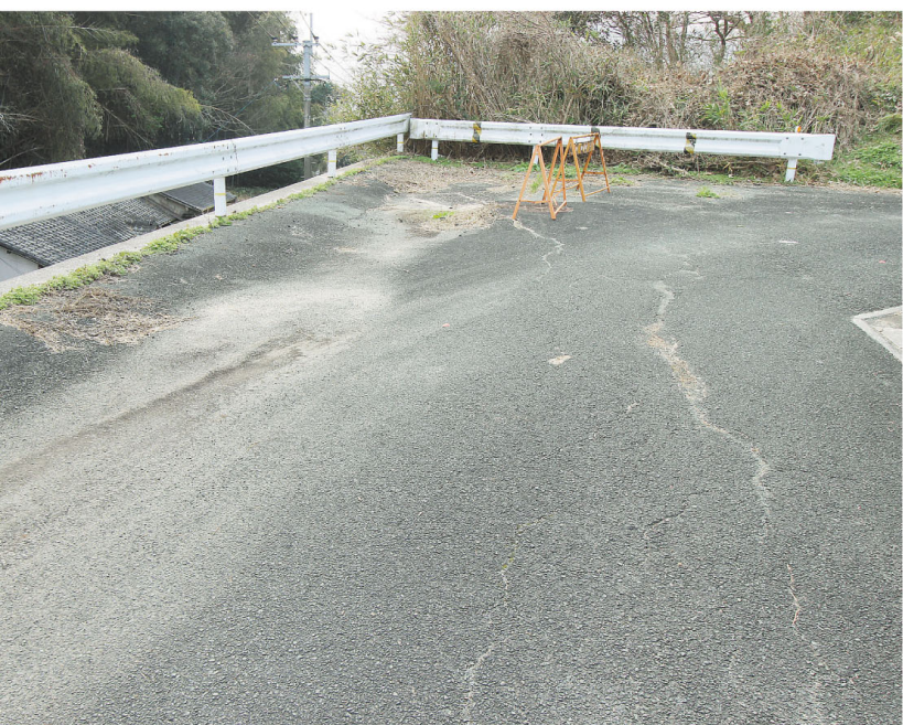
▲ ひび割れて陥没している道路(大熊分譲団地内)
