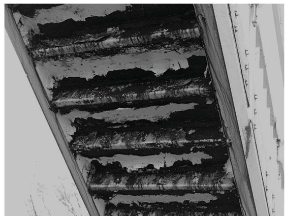
糸田駅2号横断歩道橋の補修が必要と思われる箇所
